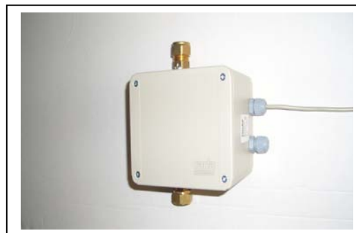
Magnetventil og elektronikkenhet montert i boks
