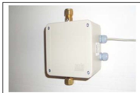
Magnetventil og elektronikkenhet montert i boks
